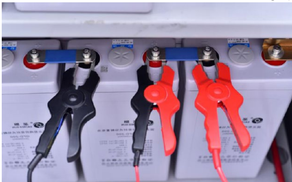
Рис. 3.1.2.2 Пример закрепления зажимов на аккумуляторной батарее
