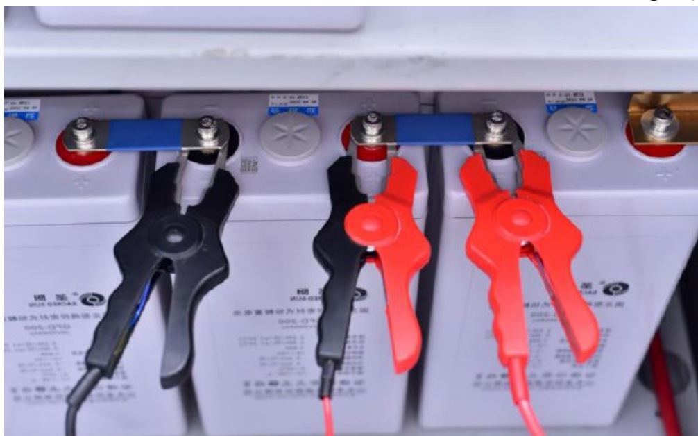
Рис. 3.1.2.2 Пример закрепления зажимов на аккумуляторной батарее
